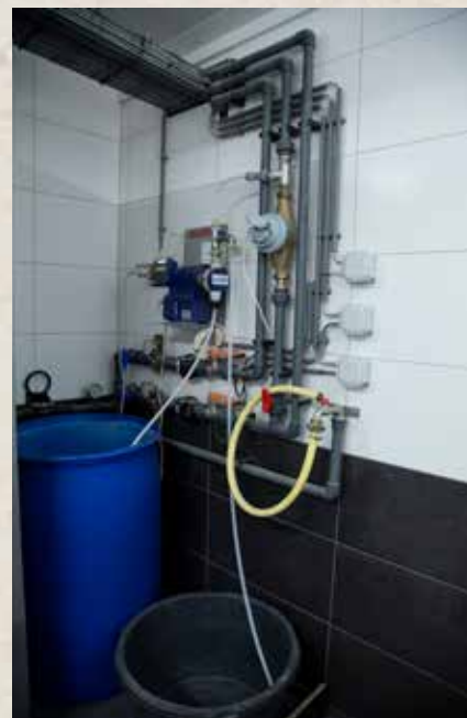
Estação de tratamento de água
